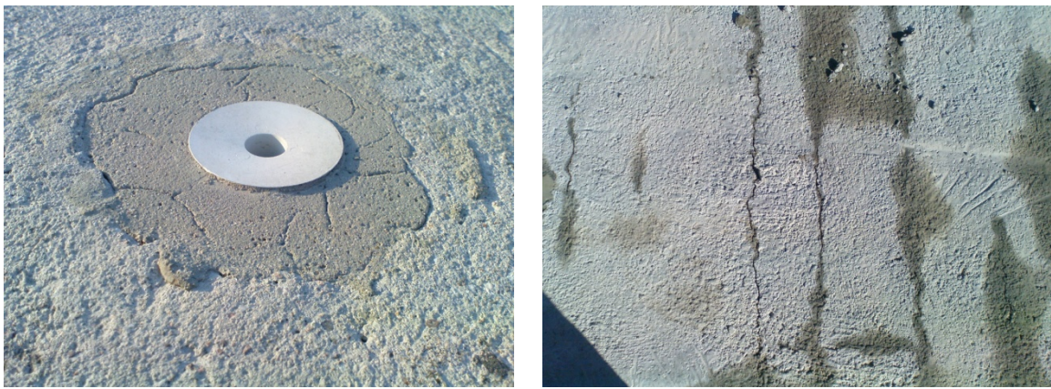
Figur 3.6 Nymonterat grundavlopp på renoveringsbro och sprickor i nygjuten brokonstruktion Edwards & Kinnmark (2010).
